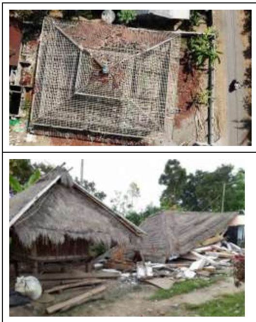
Gambar 5. Gempa yang menunjukkan kekuatan kuda-kuda yang dapat meruntuhkan bangunan
