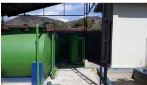
Gambar 11. Alat pengolahan limbah cair yang sudah sesuai standar
