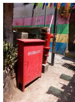
Gambar 6. Pengadaan hidran kering Sumber: Dokumentasi penulis, 2019
