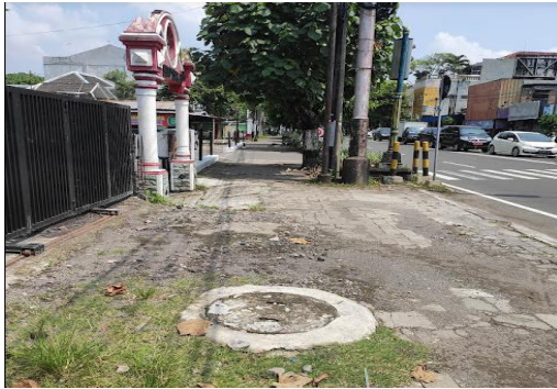
Gambar 9. Kondisi perkerasan permukaan jalur pejalan kaki di segmen 4 Sumber: Dokumentasi Eigner, 2022
