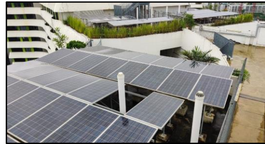
Gambar 11. Panel surya di atap Punggol Waterway Terraces untuk mendukung penerangan dan daya layanan publik di apartemen
