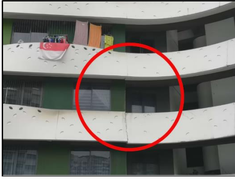
Gambar 10. Keretakan pada sambungan beberapa panel fasad di Punggol Waterway Terraces
