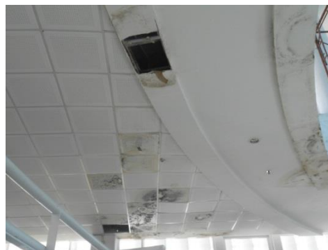
Gambar 9. Kebocoran pada plafon
