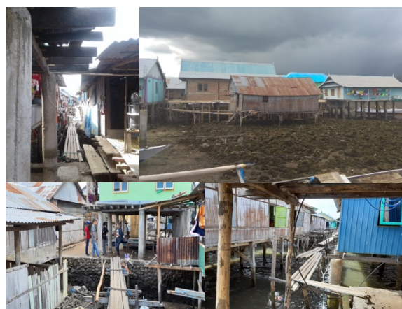
Gambar 3. Kondisi bangunan gedung pada kawasan Wuring Sumber: Hasil survey, 2019
